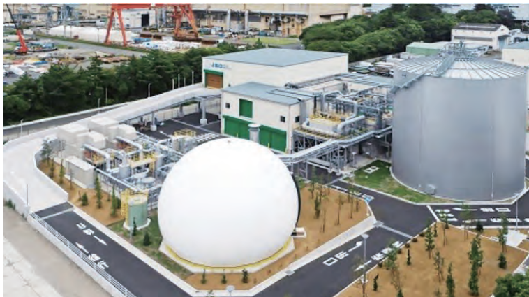
J-バイオフィードリサイクルが運営する食品リサイクル発電設備
