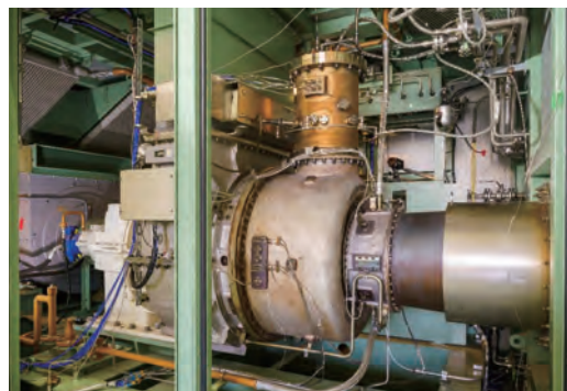
アンモニアガスタービン
